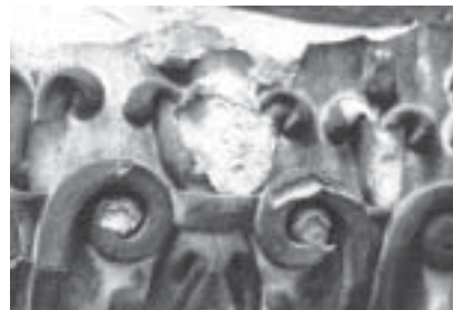
б) отслаивание участков корки, сопровождающееся осыпанием камня
