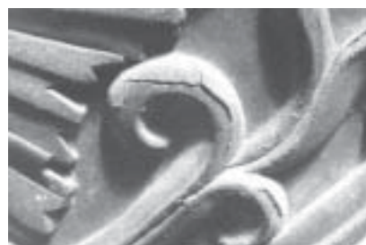
а) сплошная черная (гипсовая) корка с трещинами
